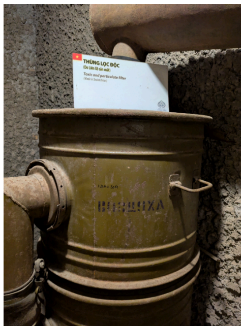
フィルター設備
