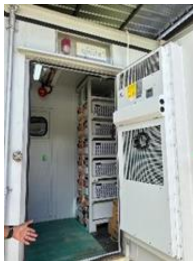
図 2.3.4. 電力制御装置
