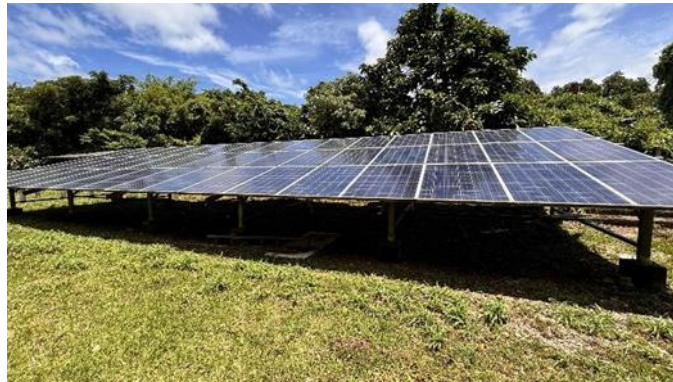
図 4.7.7. 太陽光パネル
