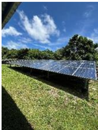
図 2.3.3. 太陽電池パネル
