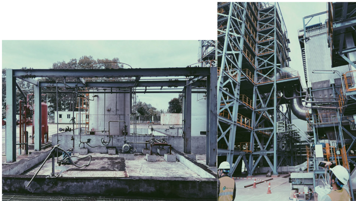
JFE 廃棄物焼却発電プラントにあるロータリー方式の焼却施設
