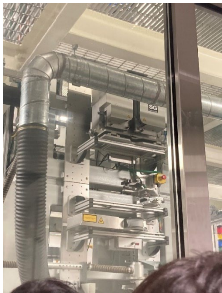
図 5-2.10 施設内の設備
