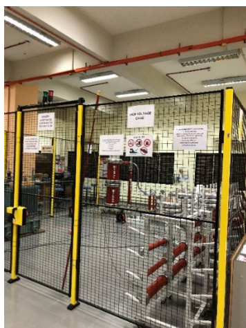
図 5-6.10 高電圧の実験施設
