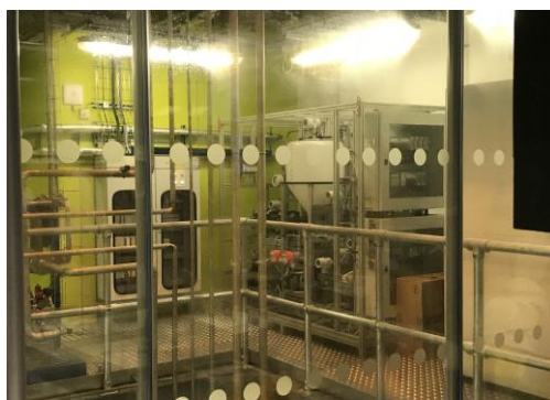
↑装置右側。制御に関わる装置が多い。
