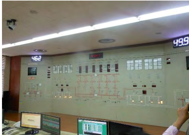
図 23 水力発電所の中央制御室
